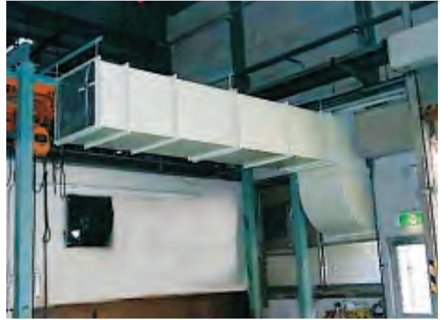
【インバーターの排熱を利用した暖房】
